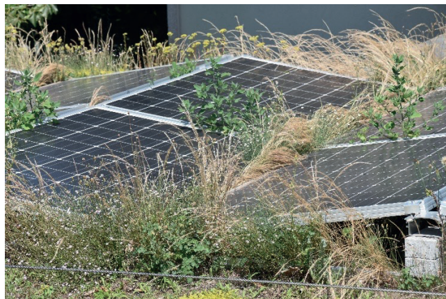
Figure 18 : Mauvais exemple de combinaison, les végétaux créent de l'ombrage sur des panneaux solaires trop bas et peu espacés (©HEPIA / P. Prunier)
