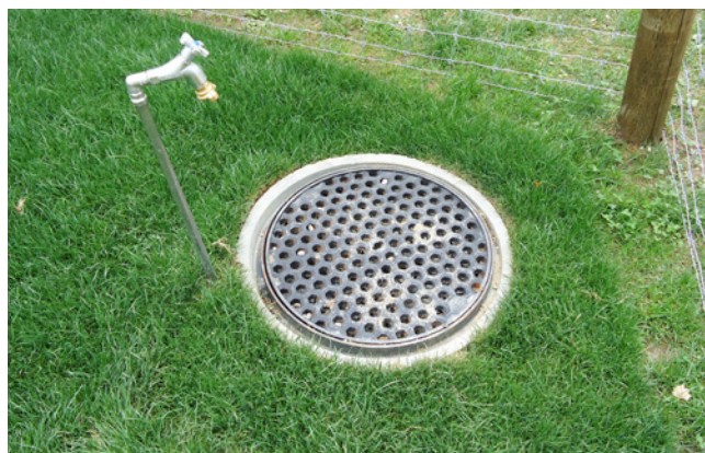
Exemple de robinet avec puits perdu.
